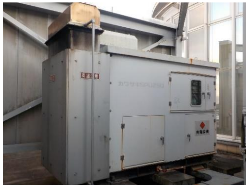
(屋上 非常用発電機)
