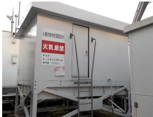
(屋上 燃料タンク)
