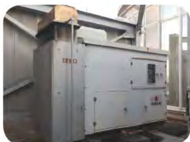
4 更新が予定されているふれあいセンター非常用発電機
