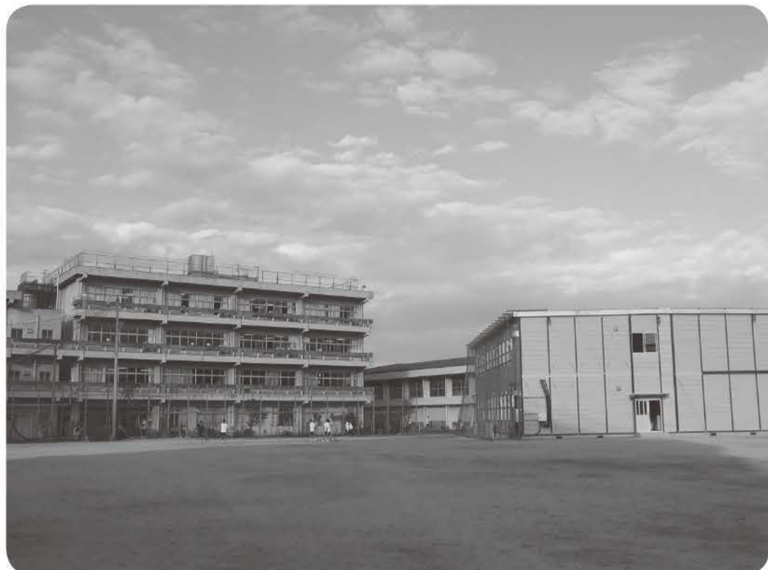
▲グラウンドに仮設校舎を建てて第一期耐震補強等工事中の第一中学校【11月6日撮影】 (各小・中学校の耐震補強工事完了予定は8面下段参照)
