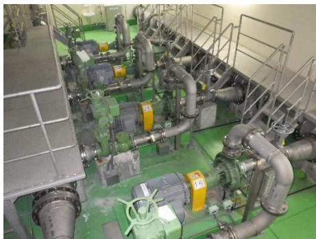
低区送水ポンプ室
