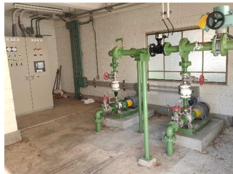
山崎加圧ポンプ室
