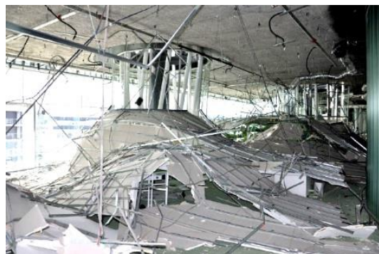
天井落下事故の事例写真
