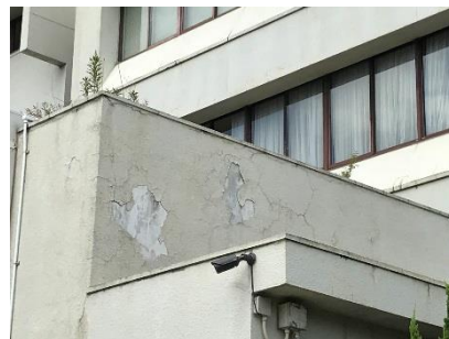
外壁塗装の剥離
