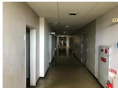
暗く通気性が悪い庁舎内
