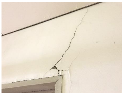
庁舎内のひび割れ(クラック)
