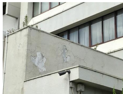
外壁塗装の剥離
