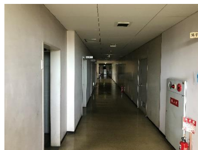
暗く通気性が悪い庁舎内
