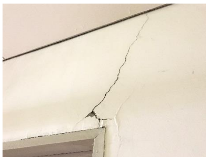
庁舎内のひび割れ(クラック)
