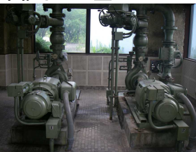
低区配水池 中継ポンプ室
