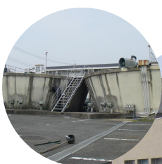
高速凝集沈殿池
