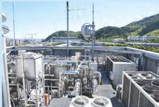
1 ふれあいセンター屋上の空調機器
