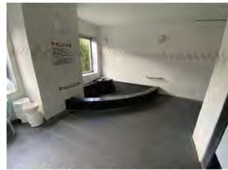
改修工事の予算が可決されたふれあいセンターの浴室 (令和5年8月撮影)
